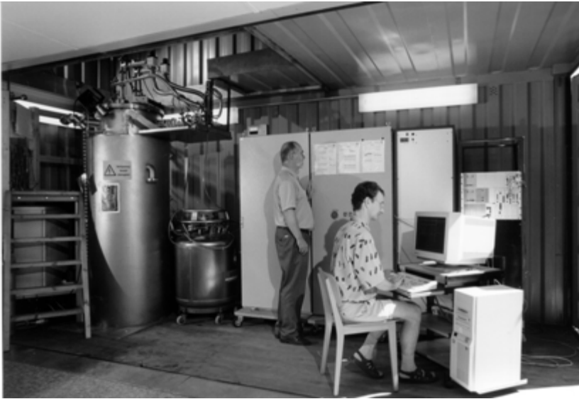
Abb. 5: Blick in den Container, in dem der SMES-Kompensator beim Feldtest aufgebaut war. Zu sehen sind von links nach rechts der Kryostat mit eingebautem SMES, eine Stickstoffkanne, der Stromrichter und die Steuerung.
